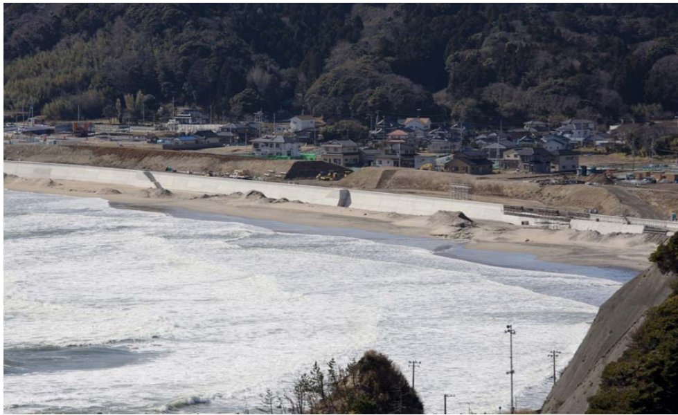
塩屋崎灯台の南に広がる豊間地区でも宅地造成工事が進められている。
