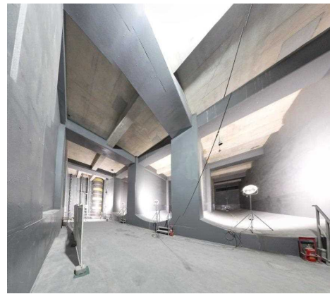
令和 2 年 8 月に供用開始した雨水貯留施設
