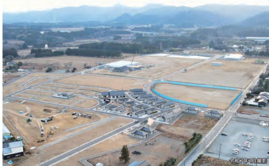
原住宅エリア（手前）では原再生賃貸住宅と分譲宅地が、大熊中央産業拠点（奥）では雇用創出の場として進出企業の建築が進んでいます。
