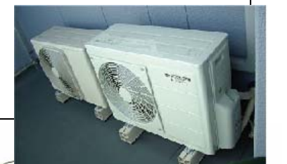
ヒートポンプ式給湯器
