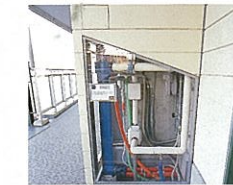
排水共用立て管
