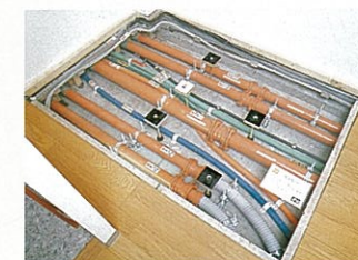
二重床内の配管
