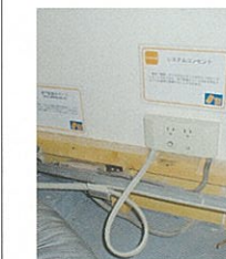
床下配線ビット
