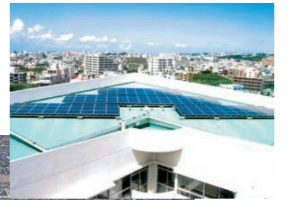
高校屋上に設置された太陽電池パネル
