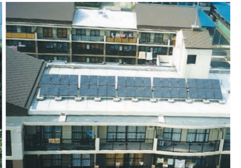
住棟屋上に設置された太陽電池パネル
