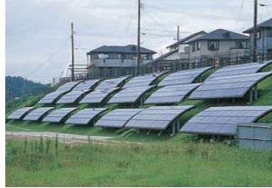
上) 県立いわき公園における緑化 下) 太陽光発電システム
