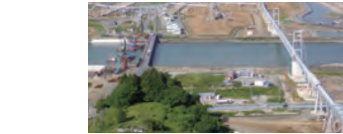
大量土の搬出のため設置された ベルトコンベア[平成27年9月作業完了] (岩手県陸前高田市)
