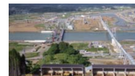
大量土の搬出のため設置されたベルト コンベア [平成 27 年 9 月作業完了] (岩手県陸前高田市)
