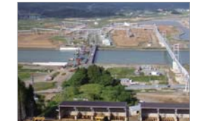
大量土の搬出のため設置された ベルトコンベヤー [平成27年9月完了](岩手県陸前高田市)
