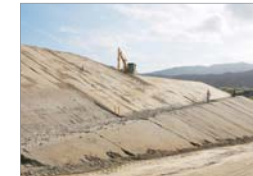
安全性の検証と宅地完成の前倒しを 目的に実施した試験盛土(陸前高田市)
