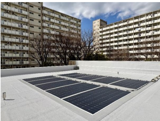
太陽光発電設備
