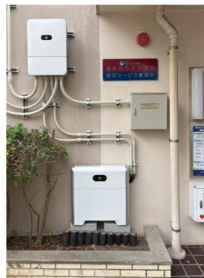
蓄電池及び居住者向け防災コンセント
