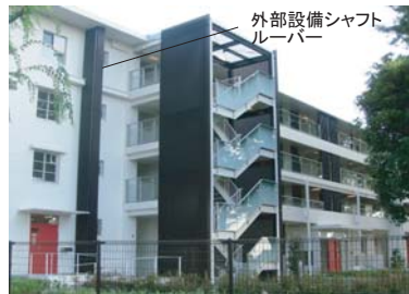
外部縦シャフトルーバー
