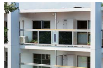
集合住宅用太陽熱利用給湯システム
