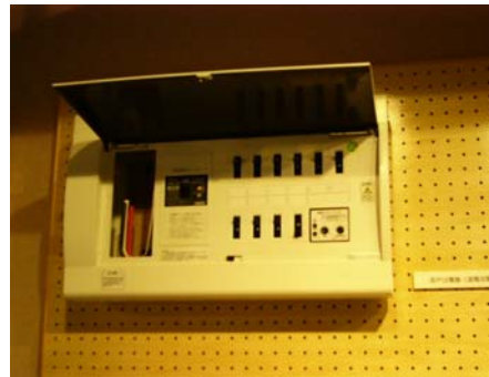
分電盤（過電流警報付）
