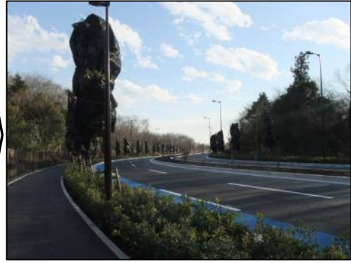
⑥国営公園南線（12月） 歩道・車道及び植栽の整備状況（完成）
