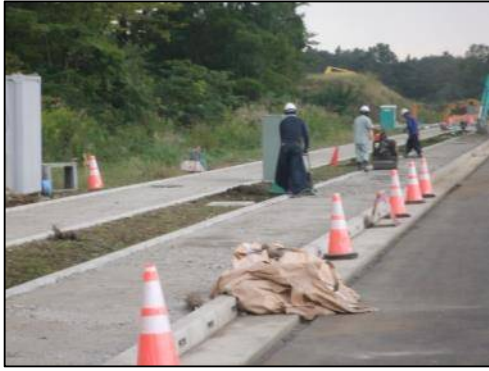
③国営公園西線（歩道・自転車道）（9月） 歩道及び自転車道の整備状況（工事中）
