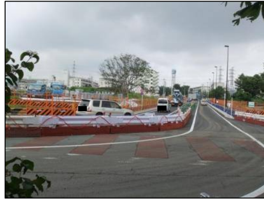
切替作業⑩ 解放後の様子（9月） 都道 153 号線の端部（新設道路に切替わる部分）付近から新設道路を撮影
