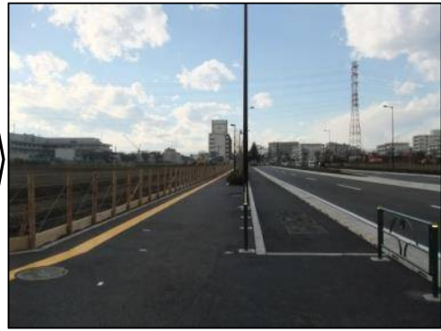
④国営公園南線（12月） 歩道・車道整備状況（完成） （奥に見える住宅は、都営中神第二アパート）
