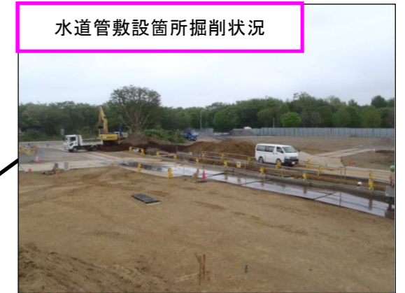
水道管理設状況
