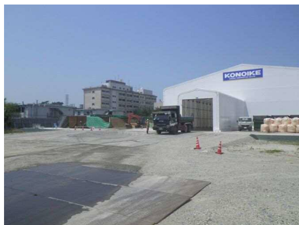
図 1.4-15 仮設洗浄処理プラント
