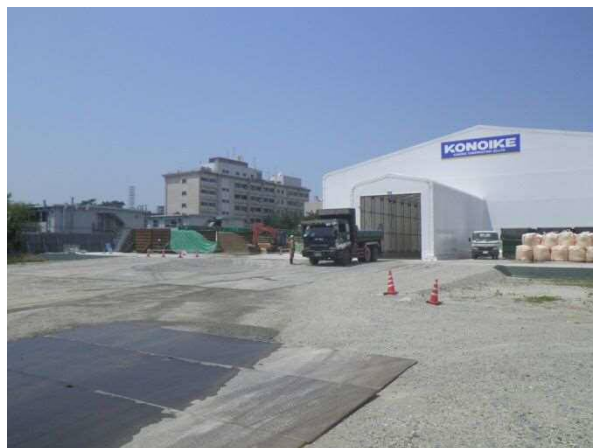
図 2.2-16 仮設洗浄処理プラント
