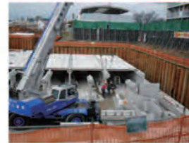
地下式調整池
