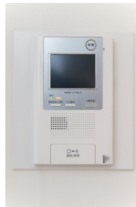
写真③ モニター付き インターホン
