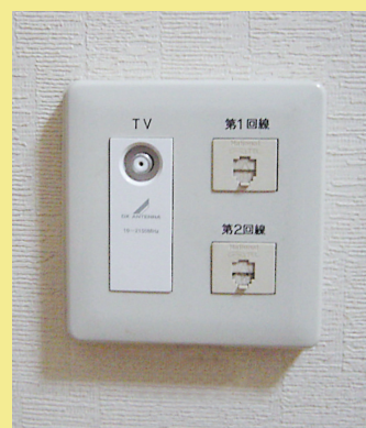
モジュージャック (写真は2回線使用できる住宅のものです)
