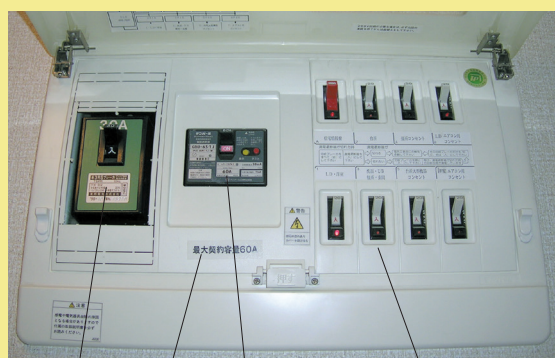
電流制限器 漏電しゃ断器 配線用しゃ断器 契約可能な最大の電気容量
