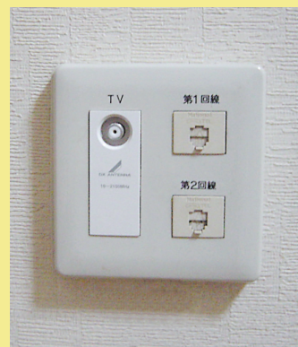
モジュラージャック (写真は2回線使用できる住宅のものです)
