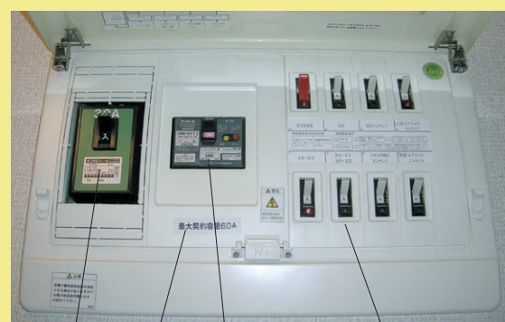
Limitador de corrente Capacidade elétrica máxima que pode ser contratada Disjuntor de aterramento Disjuntor da fiação
