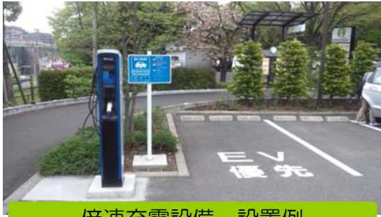
倍速充電設備 設置例
