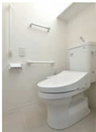
多機能便座トイレ (18号棟503号室)
