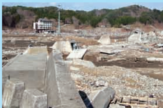
無惨に破壊された、高さ10m、延長2.4kmを誇る日本一の防潮堤(岩手県宮古市田老地区)
