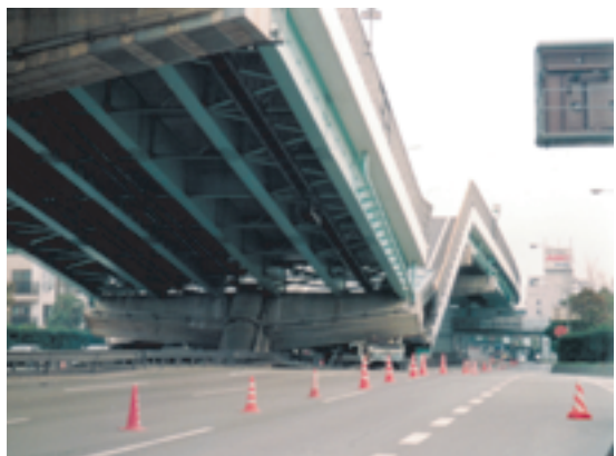
神戸市内 崩壊した阪神高速道路
