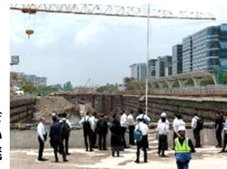
ムンバイ・アーメダバード間高速鉄道 ムンバイ駅の現場視察の様子
