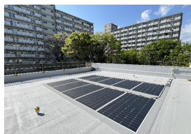
発電設備(薄型パネル)
