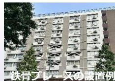
鉄骨ブレースの設置例
