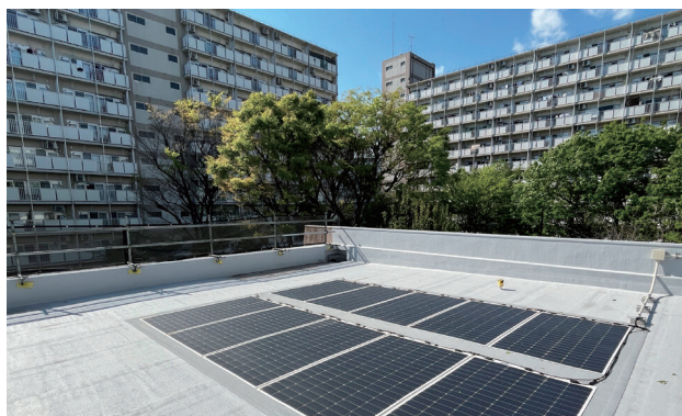
▲太陽光発電設備（フレキシブルソーラーパネル）
