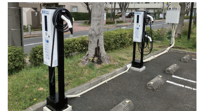
▲経堂赤堤通り団地の充電設備
