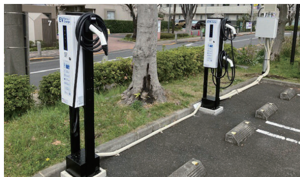
▲経堂赤堤通り団地の充電設備
