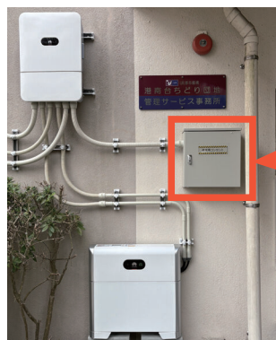
▲蓄電池及び防災用コンセント
