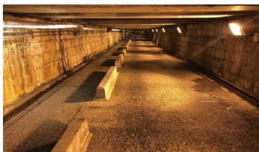
▲お化けトンネル（整備前）
