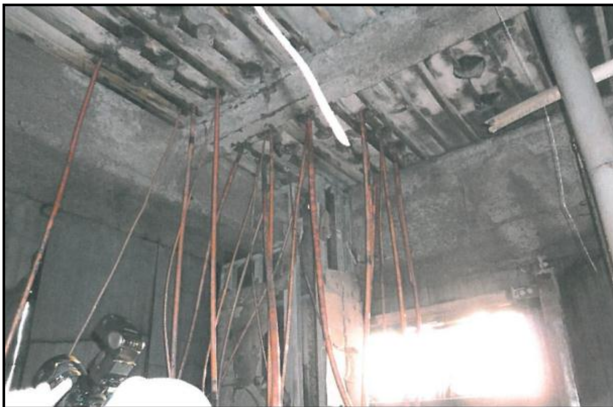
写真③：鎮火後の7階パイプシャフト・アラーム弁室
