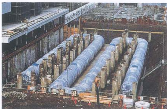
ヨーヨー広場下の災害用地下給水タンク
