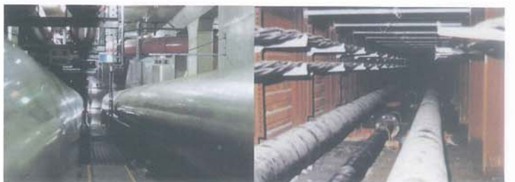
博覧会にあわせて設置した地域冷暖房管
