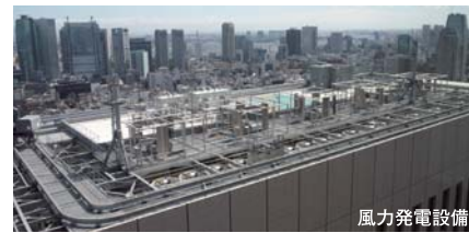
風力発電設備
