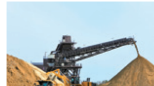
東松島市野蒜北部丘陵地区では土砂運搬用ベルトコンベヤーで工事を迅速化
