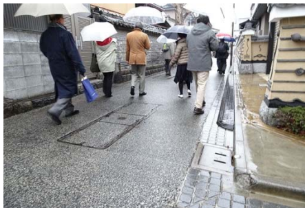
築地塀通りの電線類地中化と道路修景整備 ：無電柱化と石畳調の舗装が、シンボルの築地塀（練壁）や歴史的景観を美しく見せる。
