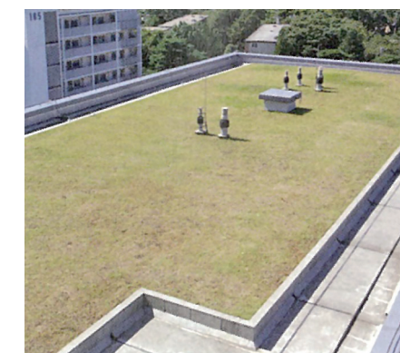
ヒートアイランド現象の緩和等に効果のある屋上緑化
