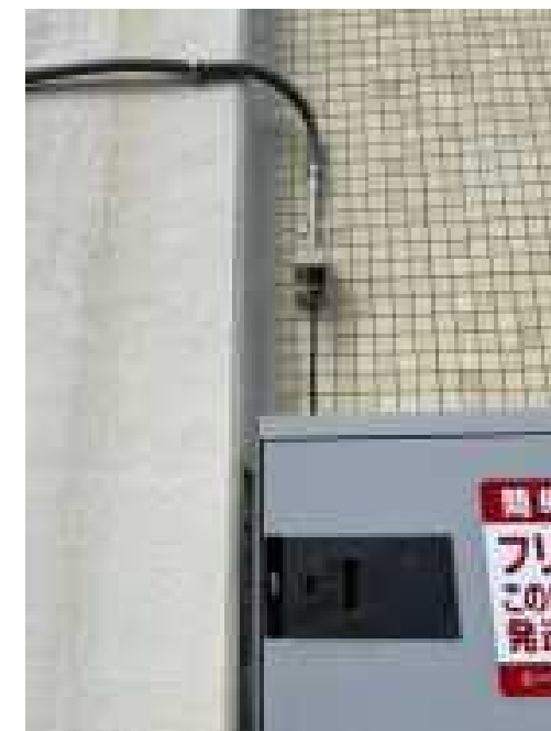
宅配BOX電源拡大
