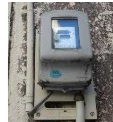
電気メーター
