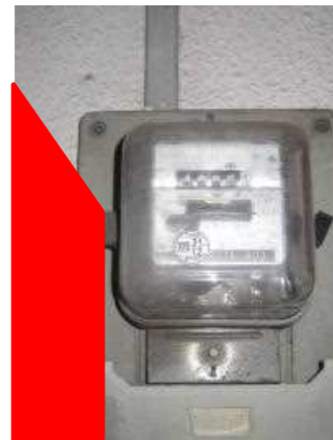
電気メーター
