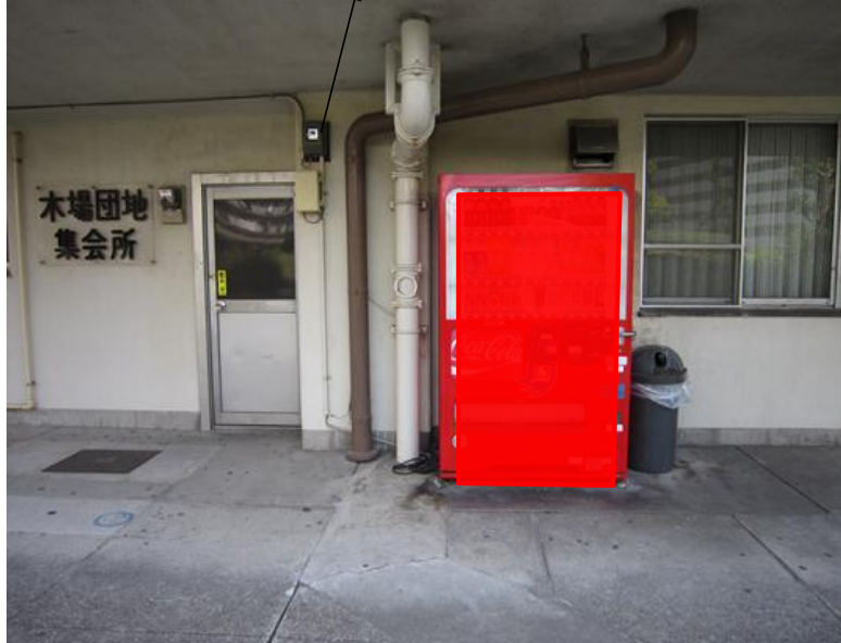
電気メーター
