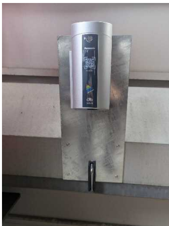
設置したEV充電設備
