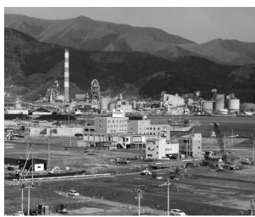
プラザホテル周辺は再開発に向けて着々と工事が進む
