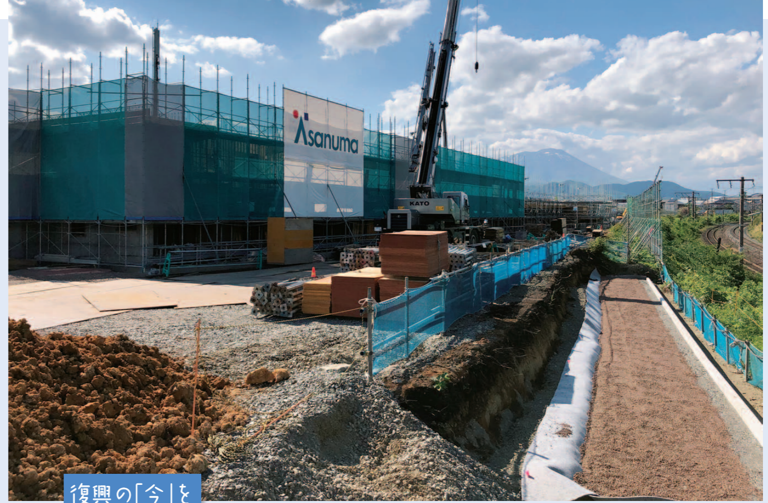
建設が進む南青山災害公営住宅(6月現在)。奥に地元のシンボルでもある岩手山(岩手県最高峰 標高2,038m)の姿が見える。
