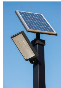
公園内に設置されたソーラー照明。停電時にも電力供給が可能となる蓄電バッテリーを備え、携帯電話などの充電ができる。
