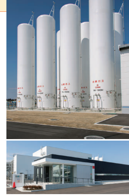
福島水素エネルギー研究フィールド。ここで製造された水素を燃料電池車や燃料電池バス向けのモビリティなどに使用する予定。
