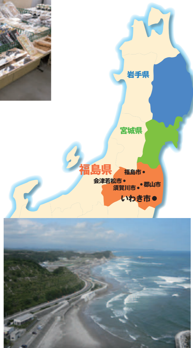
豊間と薄磯地区では高台移転のための宅地造成工事が進められている。
