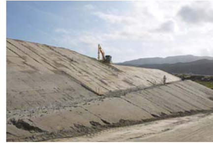
高田地区で実施した試験盛土。安全性の検証と宅地完成の前倒しという2つの目的があった
