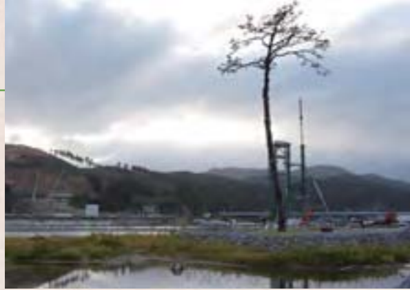
希望の象徴として再生・保存された「奇跡の一本松」。その奥で、大量の土を山から平地部に迅速に運ぶためのベルトコンベヤーの建設工事が急ピッチで進む
