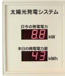
エレベーターホールには、発電量を知らせる表示板がある(シャレール荻窪)
