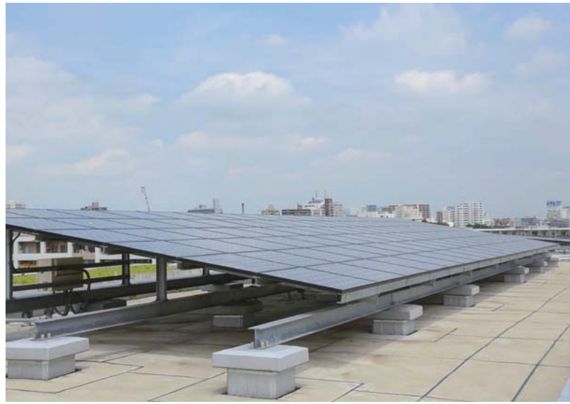
シャレール荻窪の屋上に設置した太陽光発電パネル(共用部用)。専有部用の太陽光発電パネルも共用部用とは別に設置している
